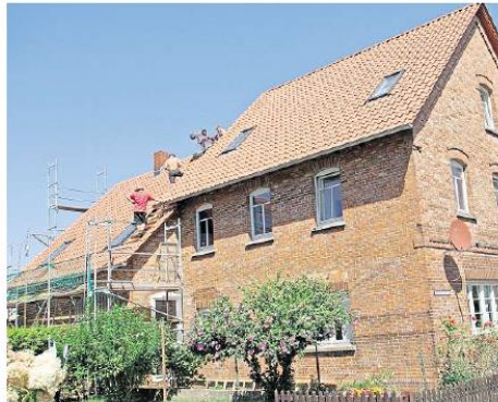
Letzte Chance: Bürger haben nur noch ein mal die Chance, bis zu 40 Prozent Fördergelder zu erhalten. FOTO: PICASA/STADT PEINE
